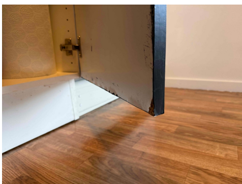
Bildet viser svelling på skapdør.
