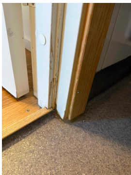
Bildet viser dørkarm og foring til badet.
