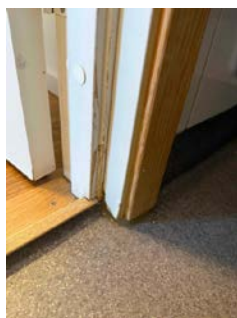
Bildet viser dørkarm og foring til badet.
