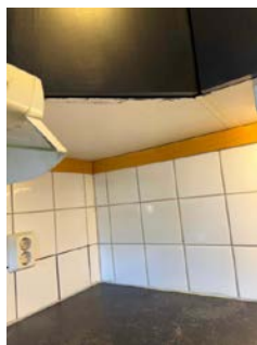
Bildet viser manglende flisfuger mellom benkeplate og overskap.
