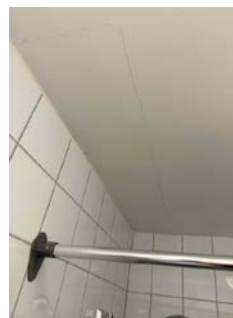
Bildet viser sprekk i taket på badet.
