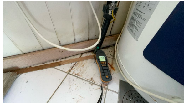
Fuktskade i tilliggende rom.
