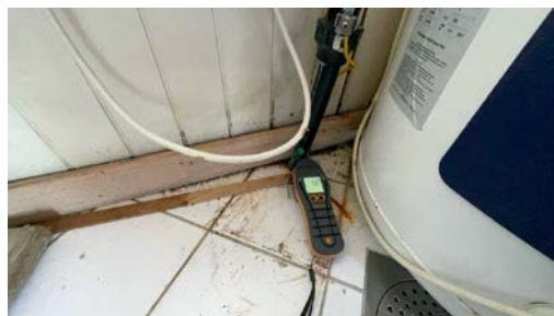
Fuktskade i tilliggende rom.
