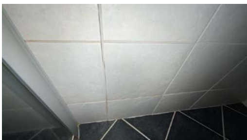
Utsnitt riss og sprekker i flisfuger.
