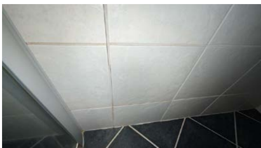
Utsnitt riss og sprekker i flisfuger.
