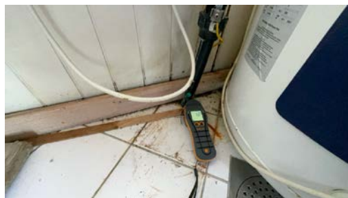
Fuktskade i tilleggende rom.
