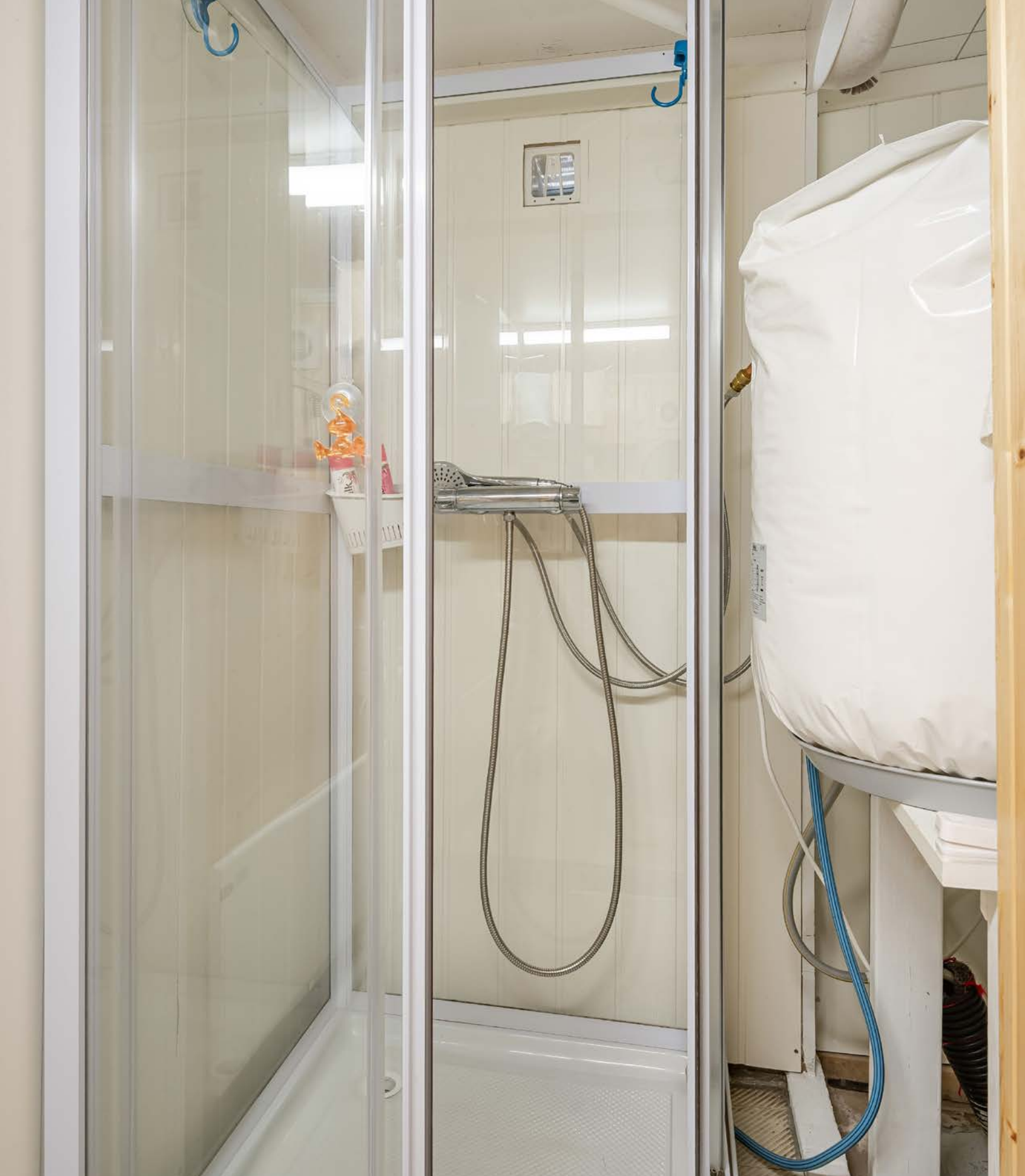
I uthuset er det også etablert et hygienekom med dusjkabinett og vanntilførsel fra bekk.
