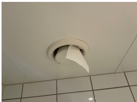
Kontroll av avtrekk.
