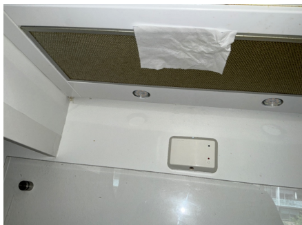
Kontroll av ventilator.
