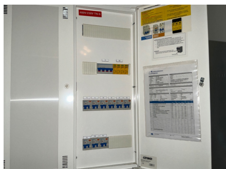
Automatsikringer i sikringsskap plassert i stue/kjøkken.
