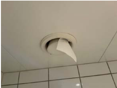
Kontroll av avtrekk.
