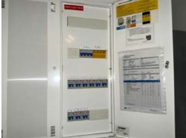
Automatsikringer i sikringsskap plassert i stue/kjøkken.
