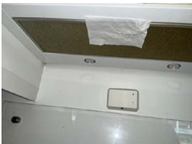
Kontroll av ventilator.
