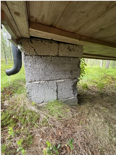
Viser sprekk og avskalling ved lecapunkt.
