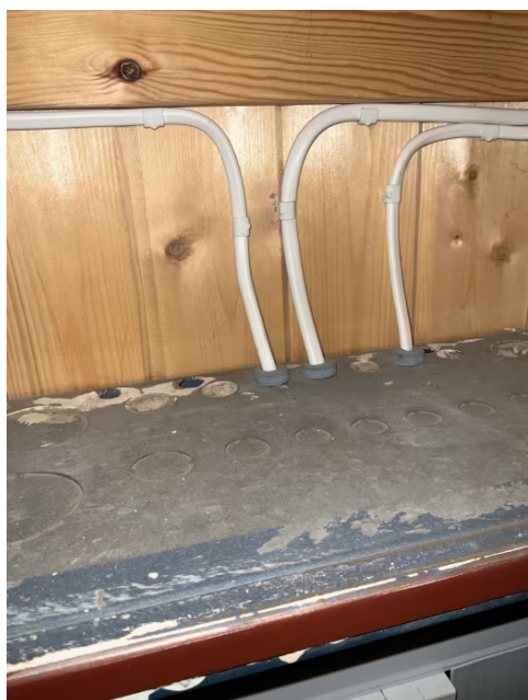
Det er hull i sikringsskap som ikke har nippelinnføringer eller er tettet med masse beregnet for formålet
