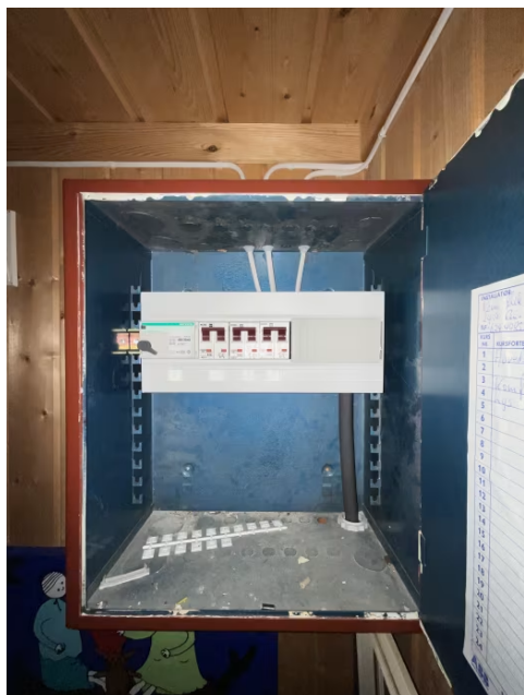
Viser sikringskap plassert på soverom.
