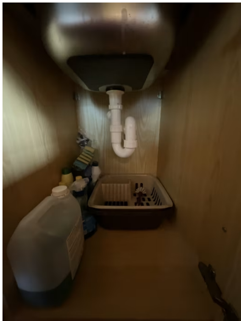
Viser avløpsinstallasjoner under kum ført til bad så videre til terreng.
