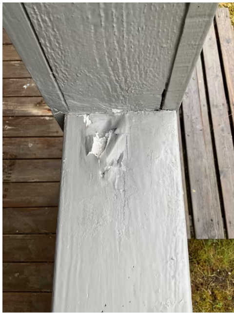
Viser mindre råteskader på håndlist.
