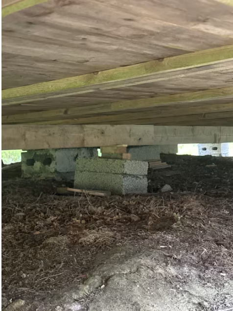
Viser skjevheter ved fundament.
