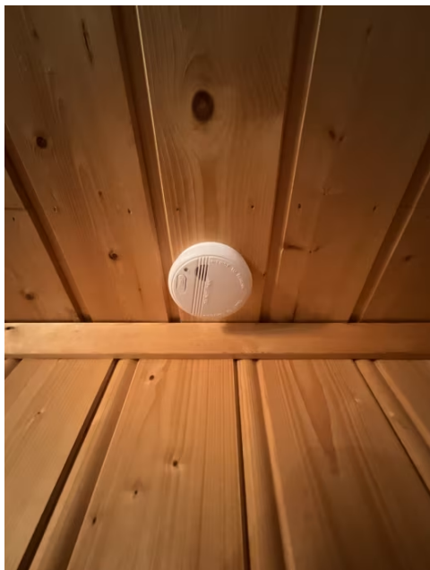
Viser brannmelding montert i himling. Montert for nært vegg.
