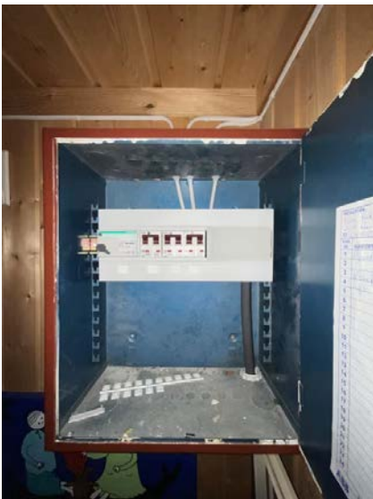
Viser sikringsskap plassert på soverom.
