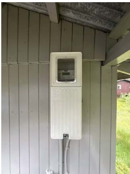
Viser inntakskap plassert på uthus.
