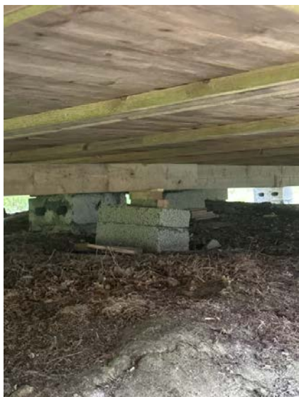
Viser skjevheter ved fundament.
