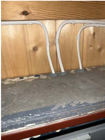
Det er hull i sikringskap som ikke har nippelinnføringer eller er tettet med masse beregnet for formålet
