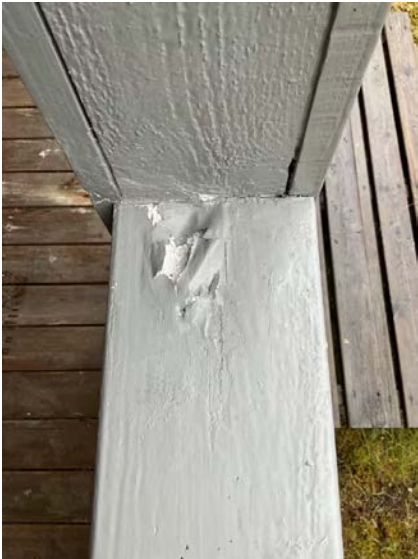
Viser mindre råteskader på håndlist.
