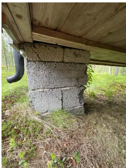
Viser sprekk og avskalling ved lecapunkt.
