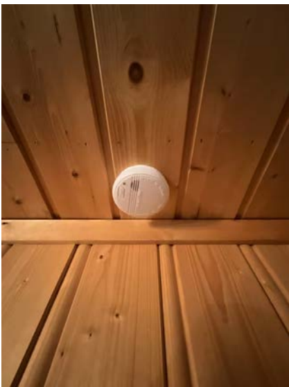
Viser brannmelding montert i himling. Monterert for nært vegg.
