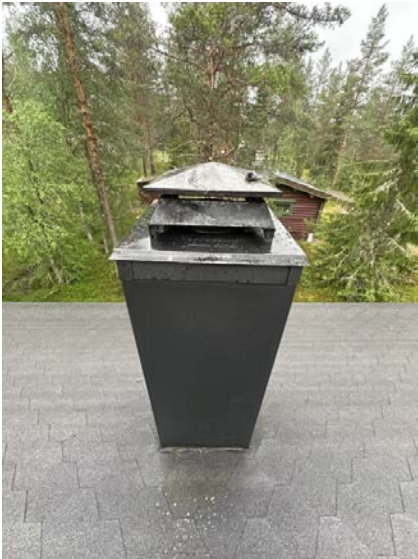
Viser helbeslått pipe over tak. Enkelte rustdannelser på beslag.
