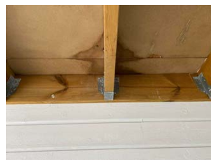
Skjolder etter tidligere lekkasje
