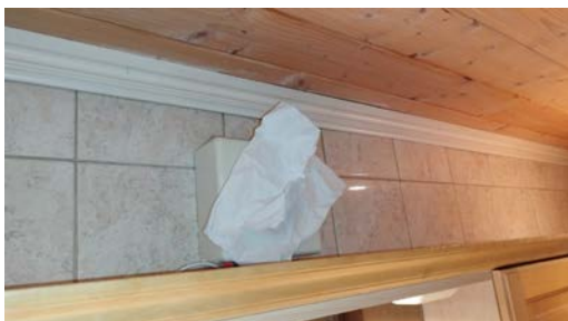
Test av avtrekket.
