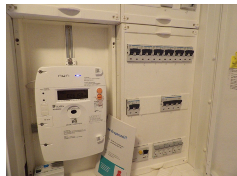
Sikringsskap i entrè.
