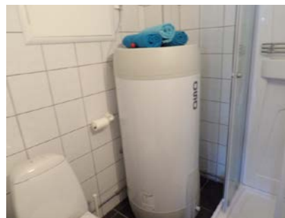
Varmtvannsbereder på bad i nedre underetasje.
