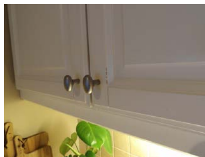
Noe slitt overflater på fronter.
