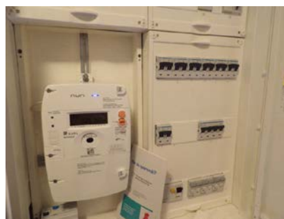
Sikringsskap i entré.
