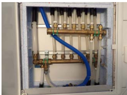
Rør i rør sentral på badet i nedre underetasje.
