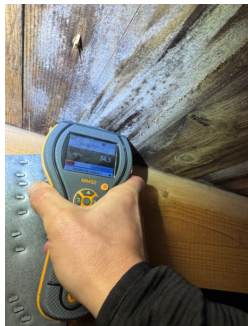
Fukttinnhold i undertak på tilbygg viser 34,5 vektprosent
