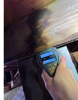
Fukttinnhold i trevirke rundt pipeløp viser 22,5 vektprosent
