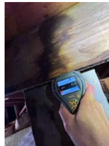
Fukttinnhold i trevirke rundt pipelep viser 22,5 vektprosent
