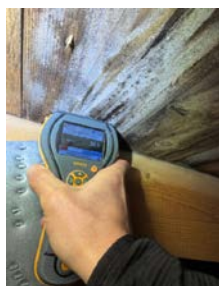
Fukttinnhold i undertak på tilbygg viser 34,5 vektprosent
