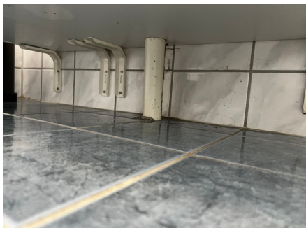
Mangler mansjett rundt rør
