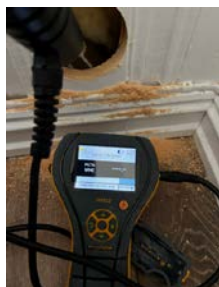
Hulltaking/ fuktmåling fra gang bak dusjhjørnet.
