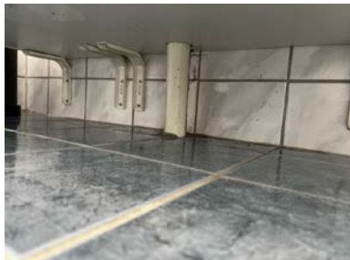
Mangler mansjett rundt rør
