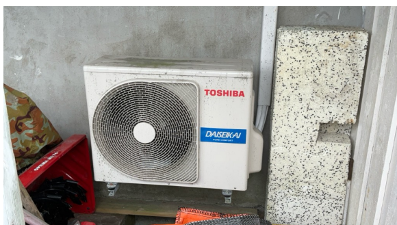
Eksempel på varmpumpe ytterdel.
