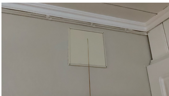
Eksempel på montert ventil i vegg.
