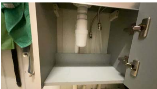
Del av rør til avløp.
