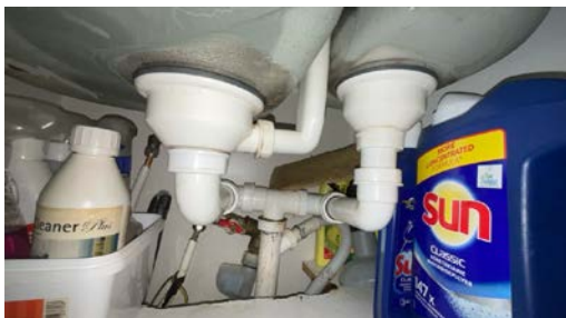
Del av rør til avløp.
