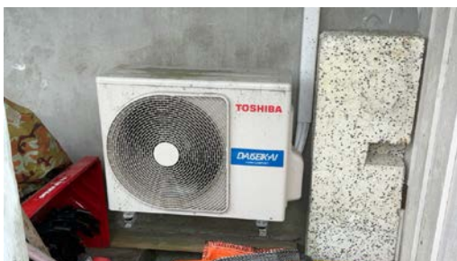
Eksempel på varmepumpe ytterdel.
