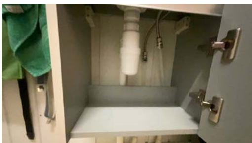
Del av rør til avløp.
