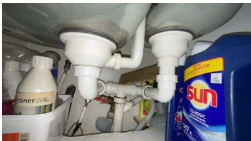
Del av rør til avløp.
