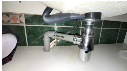
Del av rør til avløp.
