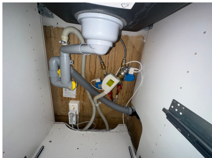
Røropplegg i kjøkkenbenk med Waterguard
