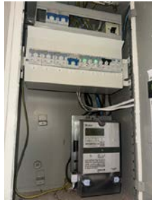
Sikringsskap med automatsikringer.
