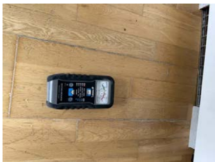
Tegn etter tidligere lekkasje /vannsøl i parkettgulv foran kjøleskap på kjøkken.
