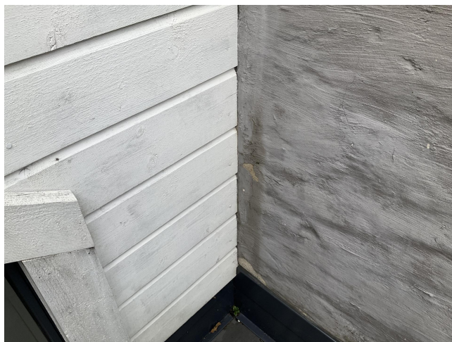
Avflassing på murpuss.
