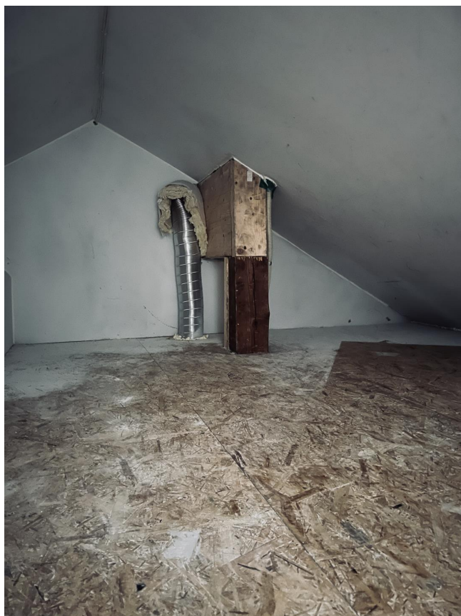
Avtrekksskanal fra ventilator, ført opp over yttertak.
