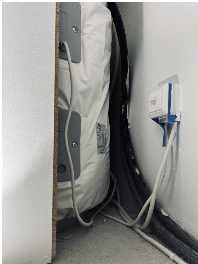
Varmtvannsbereder montert over dusj i bad.
