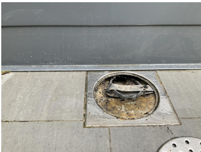
Slukløsning. Uheldig/ufagmessig løsning.
