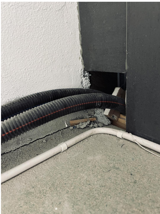
Uferdig avslutning ved rørgjennomføring ved bereder i bad.
