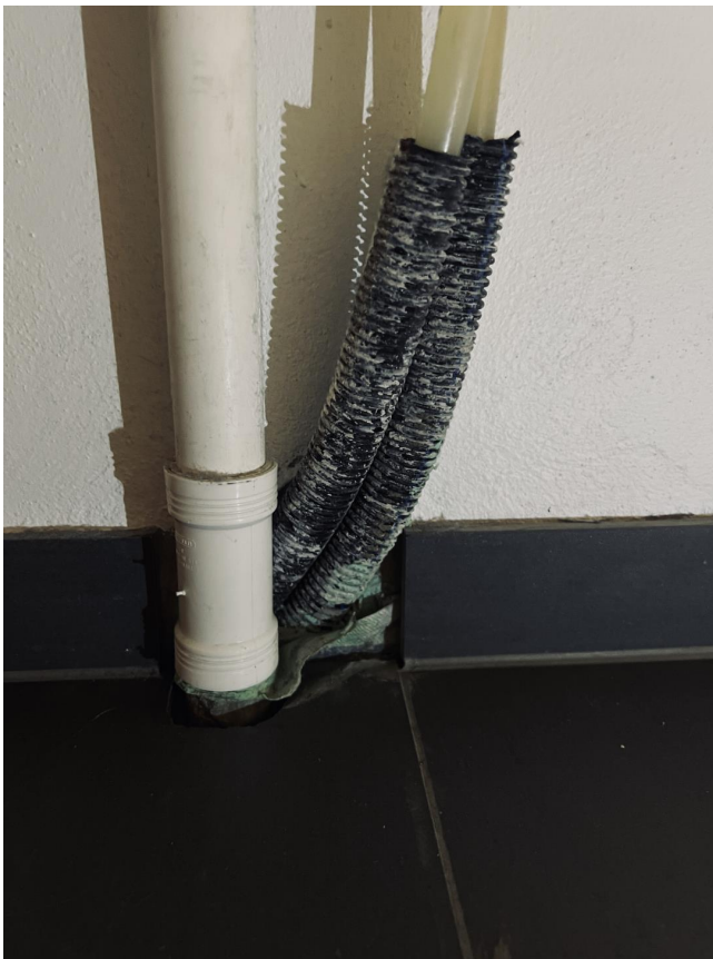
Ufagmessig løsning med avslutning/tetting rundt rørgjennomføring under servant. Fare for vanninntrenging ved lekkasje.
