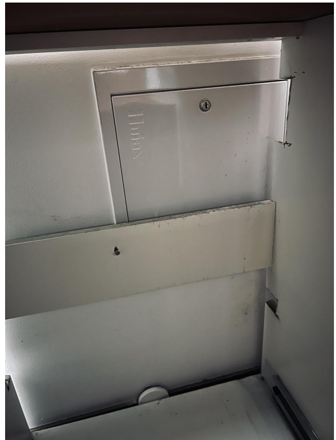
Fordelerskap i bad. Blokkert bak skap.
