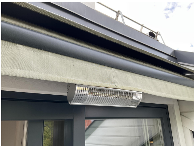
Strålevarmeovn montert inntil markise. Brannfare.
