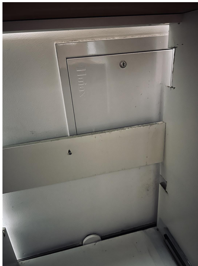
Fordelerskap blokkert bak lite og fastmontert skap.
