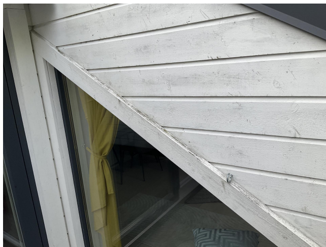
Ytterkledning. Behov for overflatebehandling.
