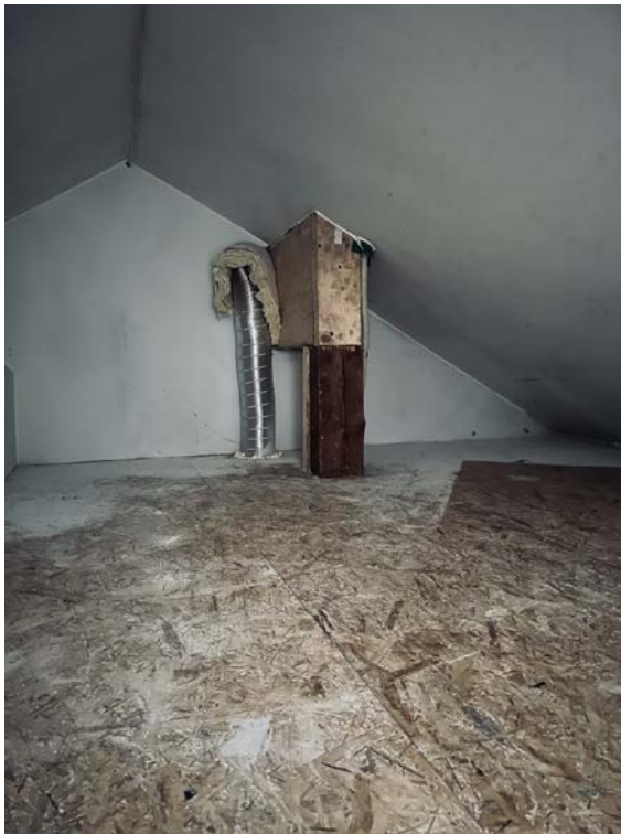
Avtrekksskanal fra ventilator, ført opp over yttertak.
