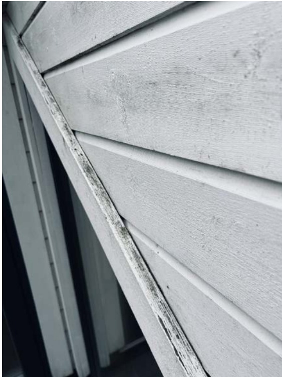
Manglende vannbrettbeslag på vindu ute på takterrasse. Fare for vanninntrenging.
