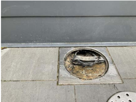
Slukløsning. Uheldig/ufagmessig løsning.
