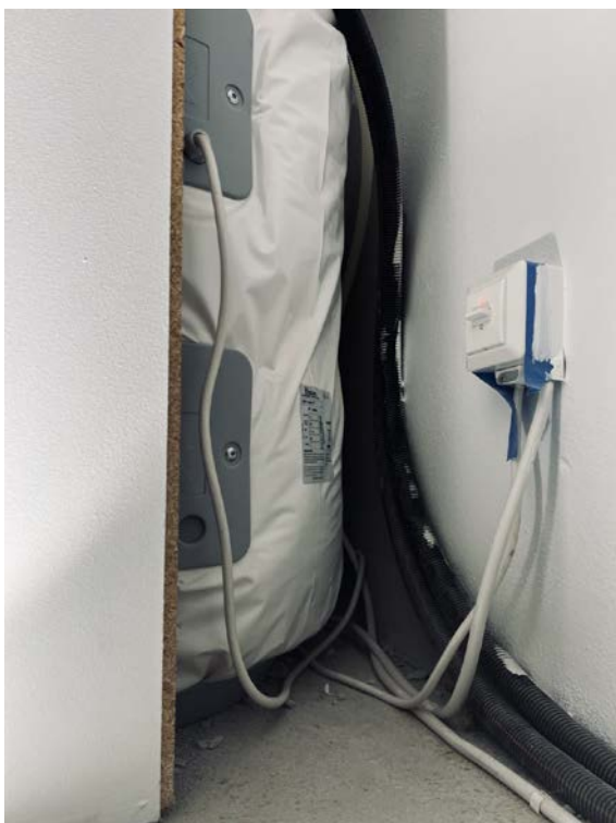
Varmtvannsbereder montert over dusj i bad.
