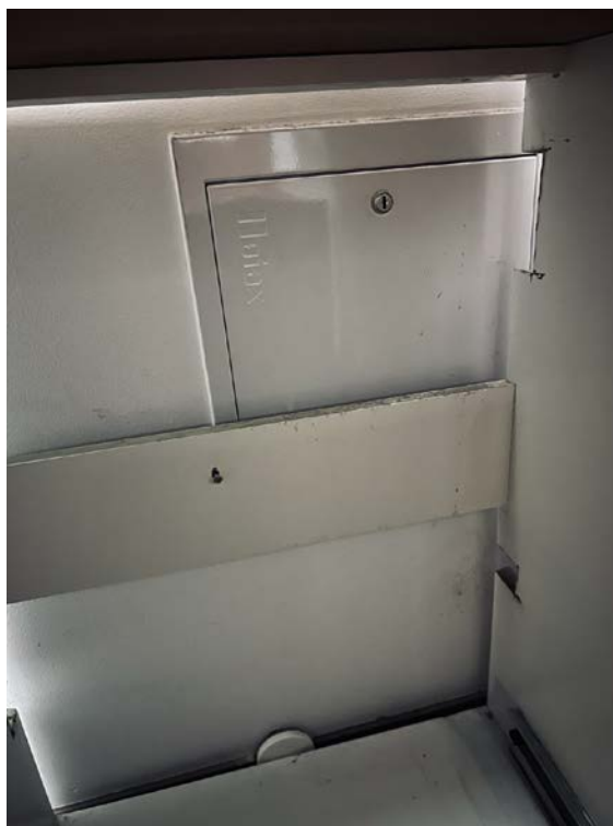
Fordelerskap blokkert bak lite og fastmontert skap.
