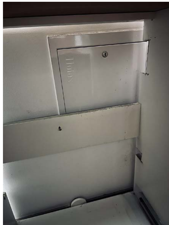
Fordelerskap i bad. Blokkert bak skap.
