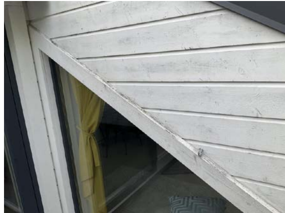
Ytterkledning. Behov for overflatebehandling.
