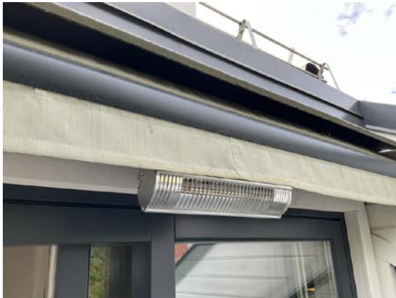
Strålevarmeovn montert inntil markise. Brannfare.
