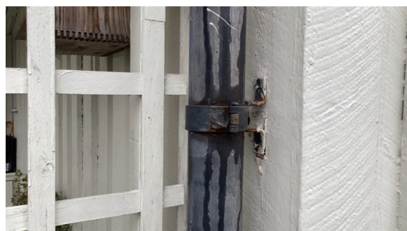
Rustskader på nedløpfester
