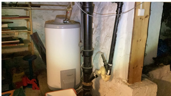
Avløpsrør i støpejern
