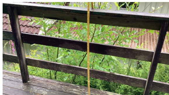
Rekkverk er lavere enn dagens krav
