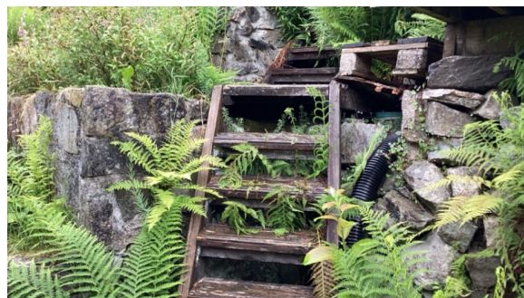
Trapp mangler rekkverk
