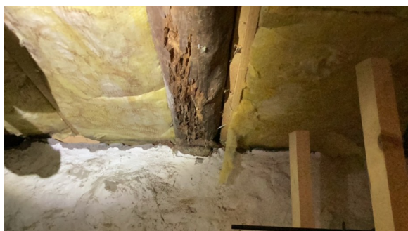
Råteskader i etasjeskiller
