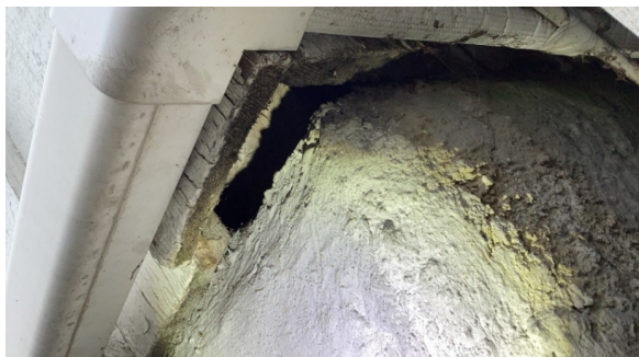
Ingen musesperre i konstruksjon
