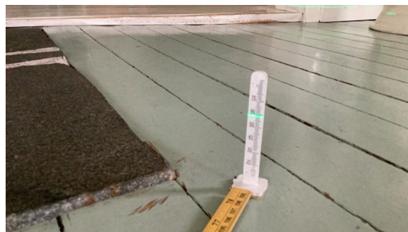
ca 29 mm høydeforskjell på gulv i stue
