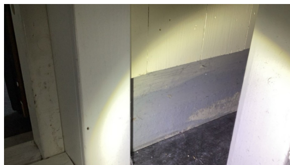
membran er smørt på vegg uten tilstrekkelig bånd i overgang
