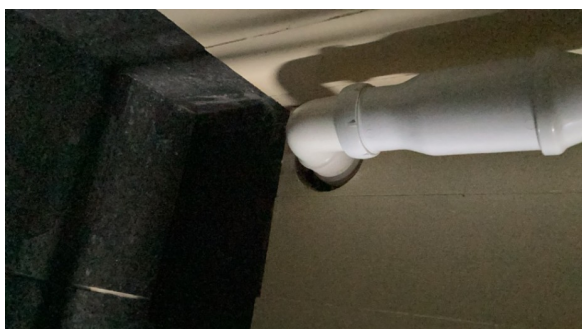
Utett / mangler mansjett rundt rør
