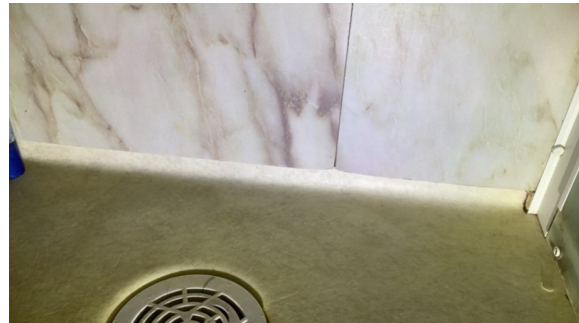
Fuktskader på plater i dusjsone
