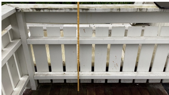
Rekkverk er lavere enn dagens krav
