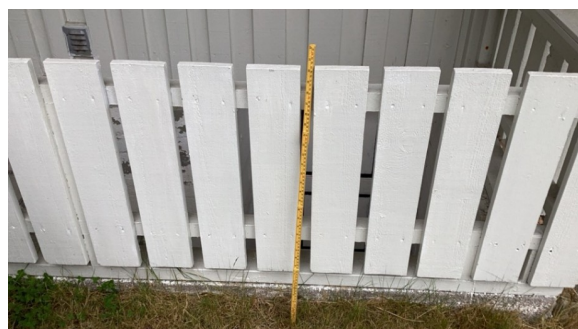
Rekkverk er lavere enn dagens krav.
