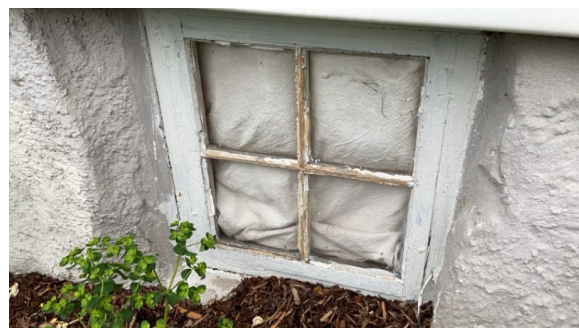
Eldre kjellervindu som er blendet, Vindu må kittes
