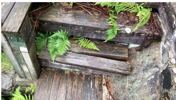
Skader i trinn
