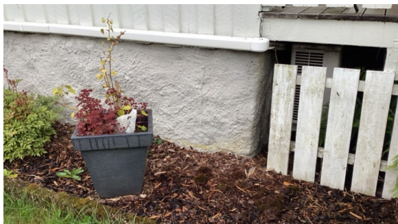
Bygget har ikke fuktsikring rundt grunnmur
