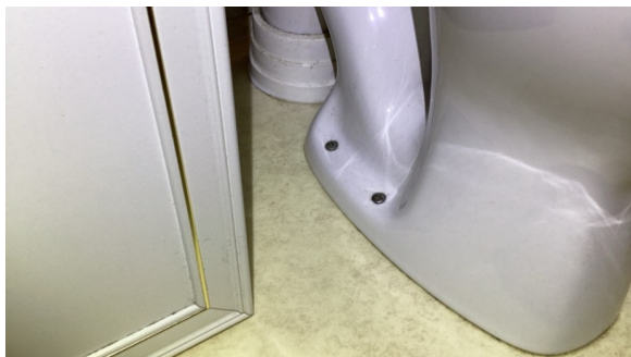
Innfesting på toalett mer montert direkte gjennom beleg
