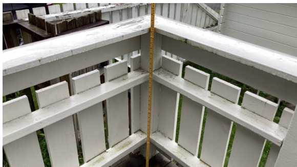
Rekkverk er lavere enn dagens krav
