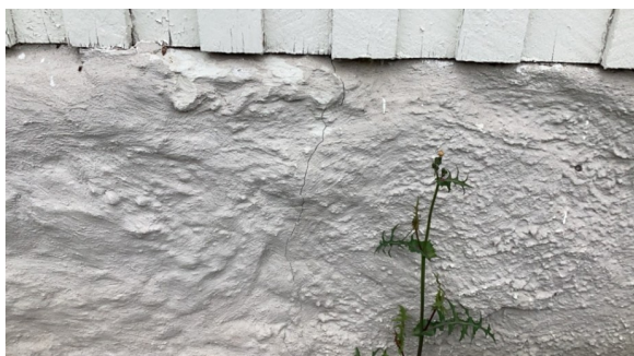
Riss i puss
