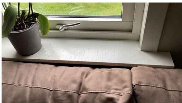
Sprekker i overflate på foring
