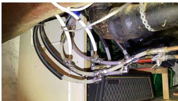
Vannrør i pex
