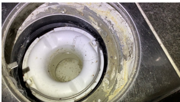
Ingen synlig mansjett under klemring i sluken
