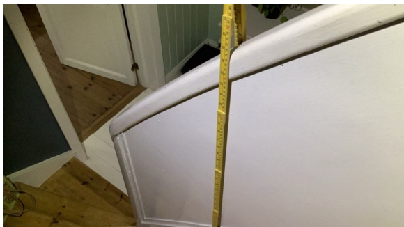
Rekkverk er lavere enn dagens krav
