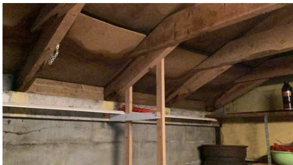
Fuktskjolder på undertak
