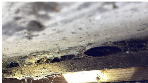
Lite eller ingen lufting bak kledning
