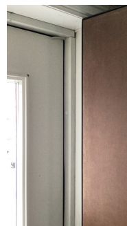
Glipe mellom blad og karm, pakning må skiftes
