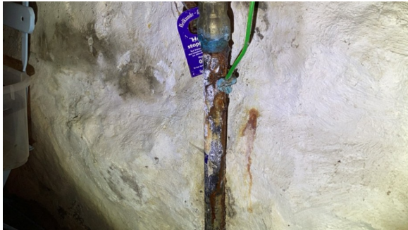
Vannrør har betydelige korrosjonsskader
