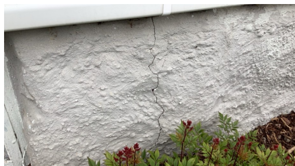
Riss i puss
