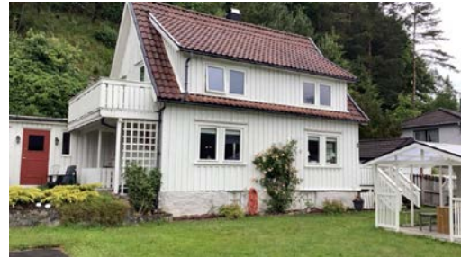
Taket har ikke snøfangere
