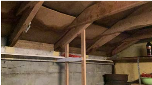
Fuktskjolder på undertak
