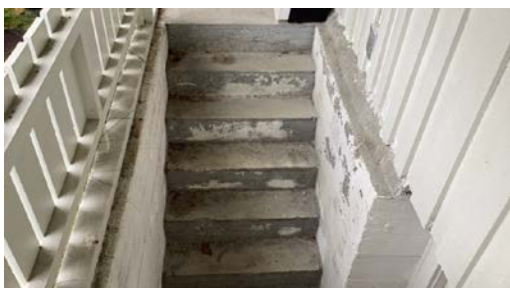
Det er ikke håndløper på vegg
