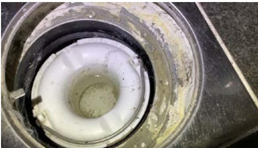
Ingen synlig mansjett under klemring i sluken
