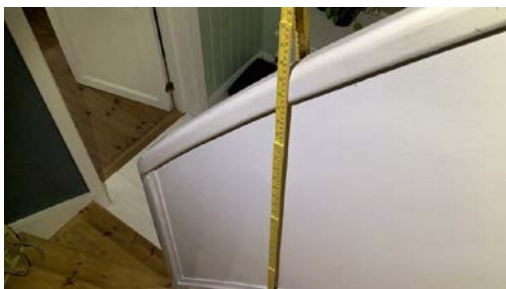
Rekkverk er lavere enn dagens krav
