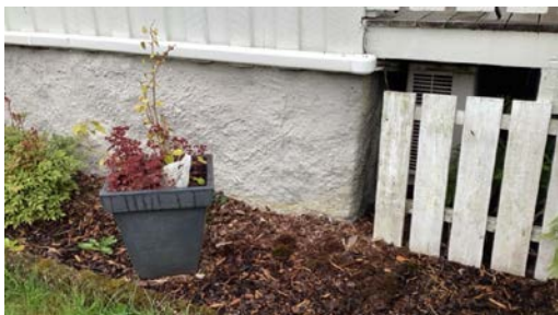
Bygget har ikke fuksikring rundt grunnmur
