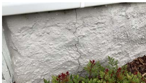
Riss i puss
