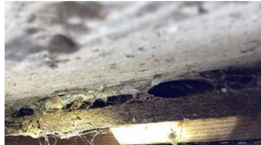
Lite eller ingen lufting bak kledning
