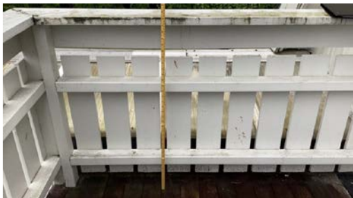
Rekkverk er lavere enn dagens krav
