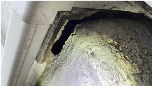
Ingen musesperre i konstruksjon
