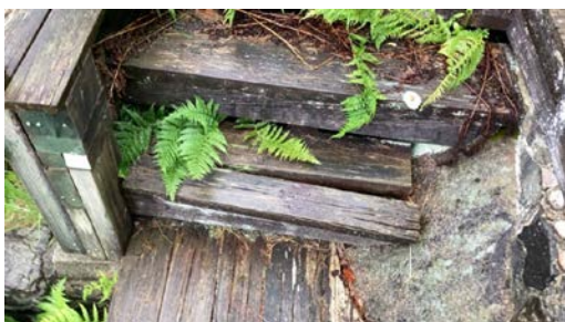
Skader i trinn
