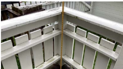
Rekkverk er lavere enn dagens krav
