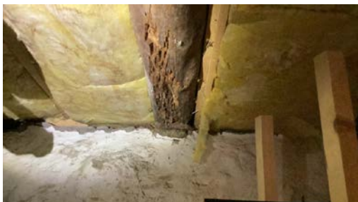
Råteskader i etasjeskiller
