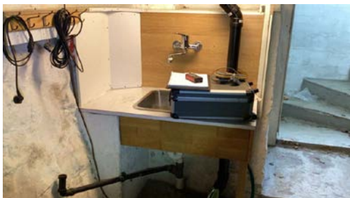
Utslagsvask i kjeller
