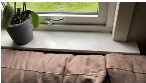
Sprekker i overflate på foring
