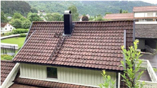
Taket har ikke snøfangere
