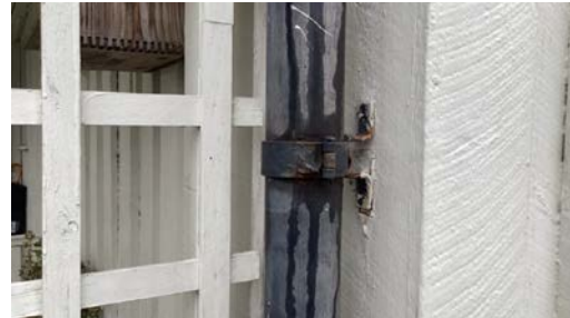
Rustskader på nedløpfester
