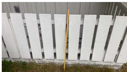
Rekkverk er lavere enn dagens krav.
