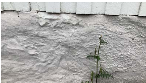
Riss i puss
