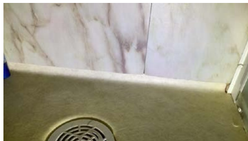
Fuktskader på plater i dusjsone
