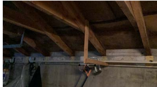
Fuktskjolder på undertak
