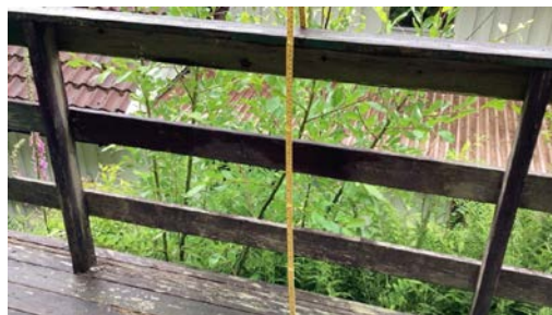
Rekkverk er lavere enn dagens krav
