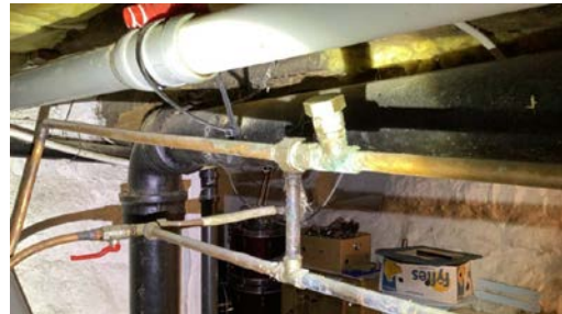
Vannmåler og stoppekran
