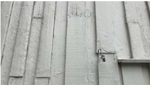
Spredt råte i kledning
