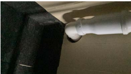
Utett / mangler mansjett rundt rør
