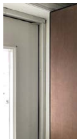
Glipe mellom blad og karm, pakning må skiftes
