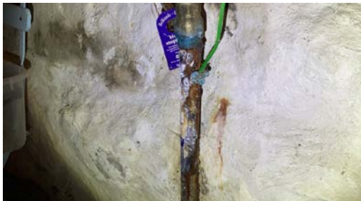
Vannrør har betydelige korrosjonsskader
