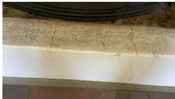
Eksempel på sprekk i overflate på peis.
