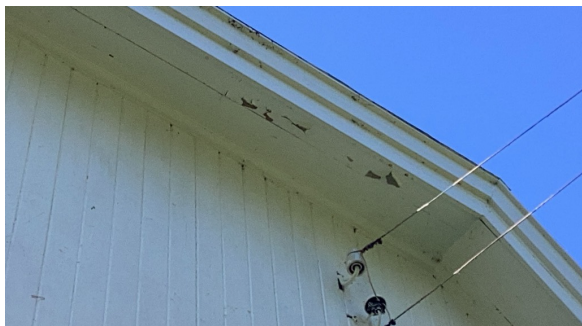
Eksempel på slitasje.
