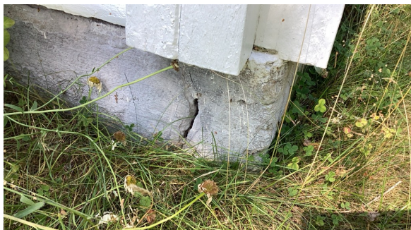
Eksempel på sprekk i grunnmur.
