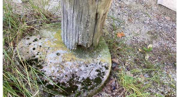
Begynnende råteskade i stolpe.
