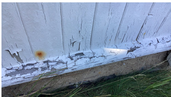
Eksempel på slitasje.
