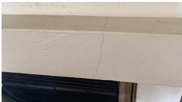
Eksempel på sprekk i overflate på peis.
