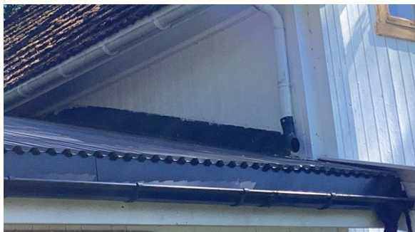
Beslag i overgang mot tilbygg er lagt utenpå kledning.
