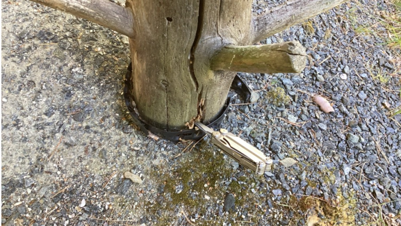
Begynnende råteskade i stolpe.
