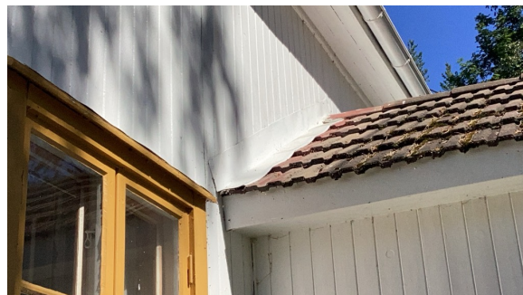
Beslag i overgang mot sekundærentre er lagt utenpå kledning.
