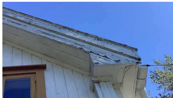
Eksempel på slitasje.
