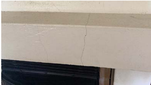
Eksempel på sprekk i overflate på peis.
