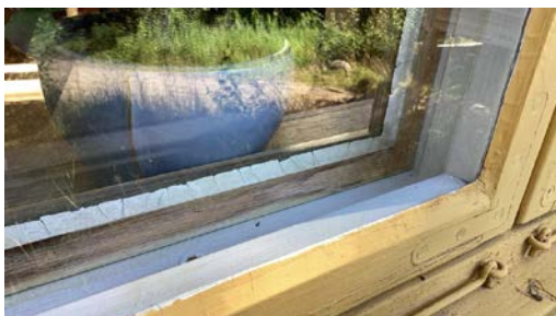
Eksempel på slitasje.
