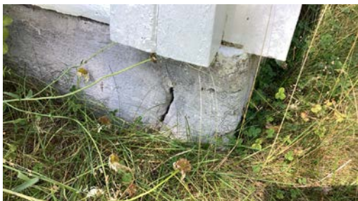
Eksempel på sprekk i grunnmur.
