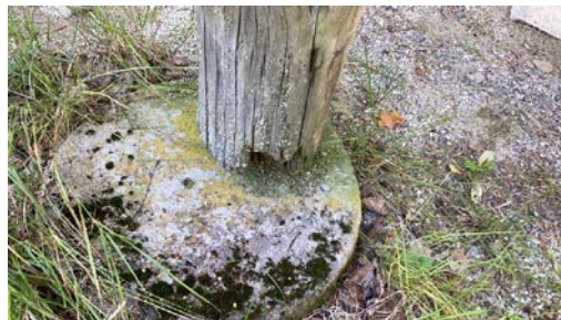
Begynnende råteskade i stolpe.
