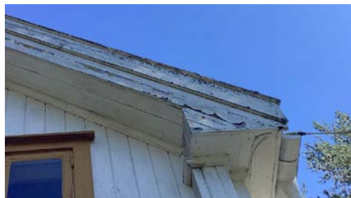
Eksempel på slitasje.
