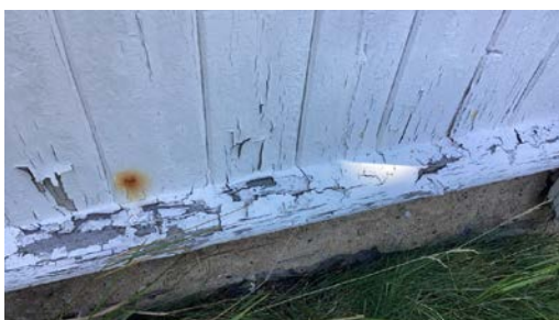
Eksempel på slitasje.
