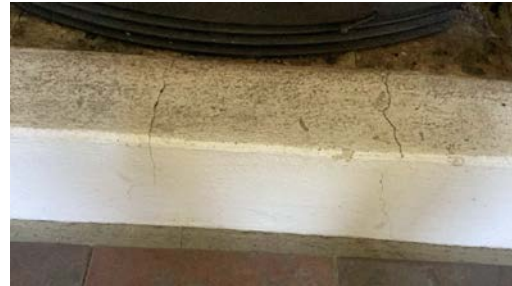
Eksempel på sprekk i overflate på peis.
