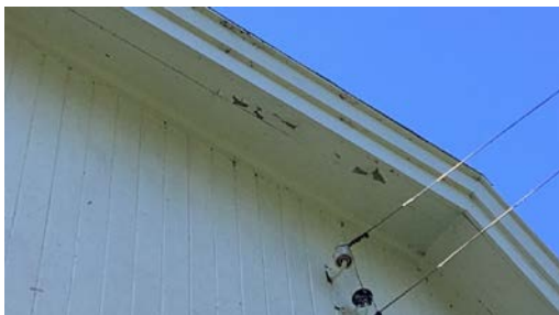
Eksempel på slitasje.
