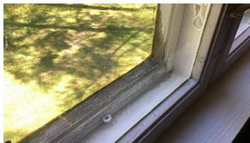
Eksempel på slitasje.
