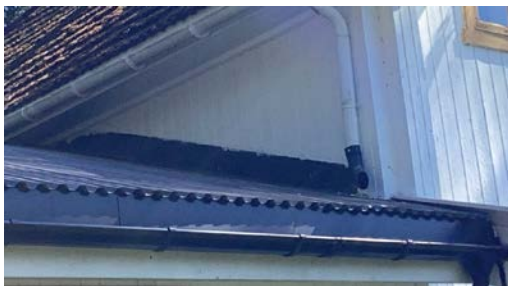
Beslag i overgang mot tilbygg er lagt utenpå kledning.
