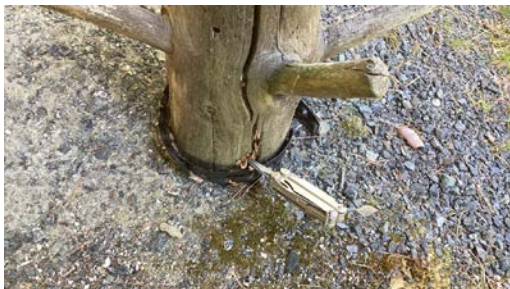
Begynnende råteskade i stolpe.
