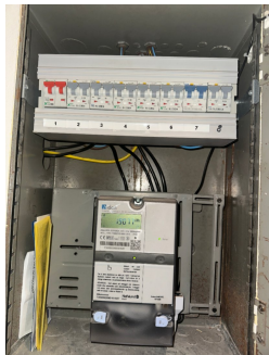
Sikringsskap med automatsikringer.
