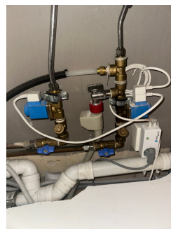
Rørøpplagg i kjøkkenbenk med Waterguard
