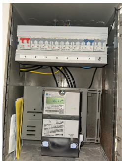
Sikringsskap med automatsikringer.
