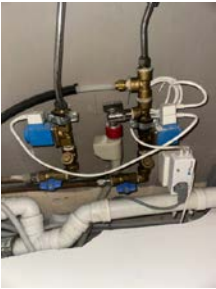
Røropplegg i kjøkkenbenk med Waterguard
