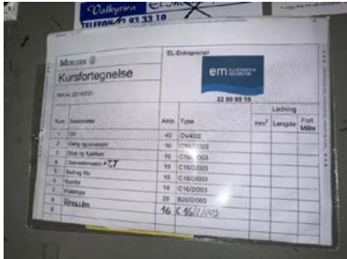
Kursoversikt i sikringsskap
