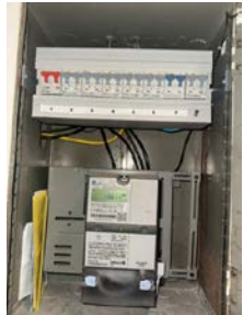
Sikringsskap med automatsikringer.
