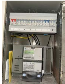
Sikringsskap med automatsikringer.
