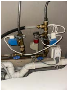
Røropplegg i kjøkkenbenk med Waterguard
