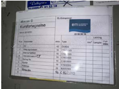
Kursoversikt i sikringsskap
