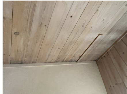
Synlig fuktspor innvendig tak.
