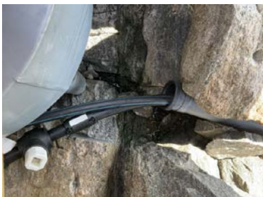
Rør til avløp og vann.
