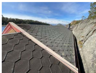
Synlig skjevheter i konstruksjon.
