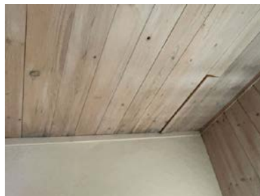
Synlig fuktspor innvendig tak.
