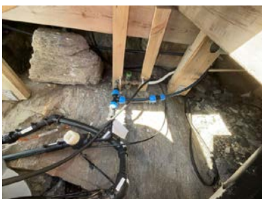
Del av rør til vann. Stoppekran til vann.
