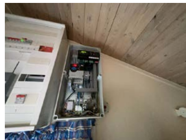
Styreskap til pumpe kum.
