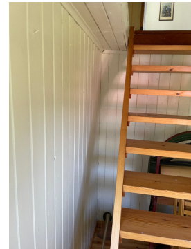
Manglende sikring i form av rekkverk og stor lysåpning mellom trinn.
