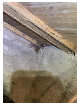
Påbegynte råteskader i bjelke ved mur.
