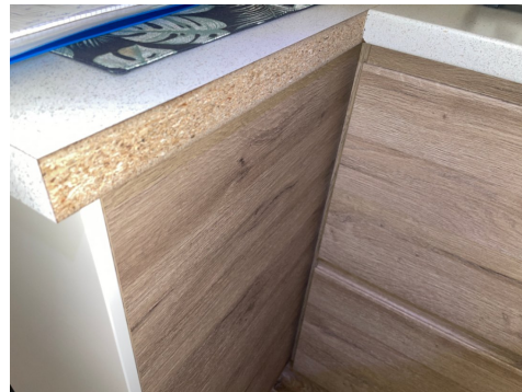
Synlig trefylling på benkeplate.
