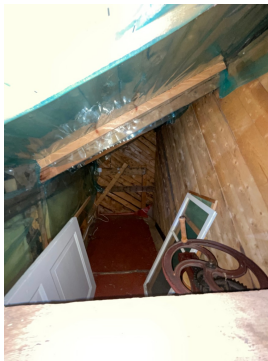
Ufaglig montering av diffusjonssperre
