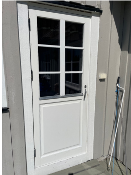
Manglende omramning ved topp karm.
