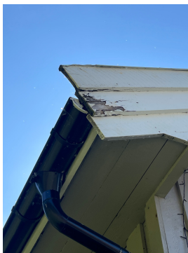
Oppsprukket trevirke / påstartet fukt og råteskader i endeved.
