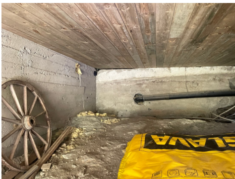
Manglende ventilering og en tettet ventil .
