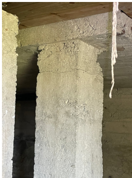
Horisontal sprekk på søylepunkt tilbygg
