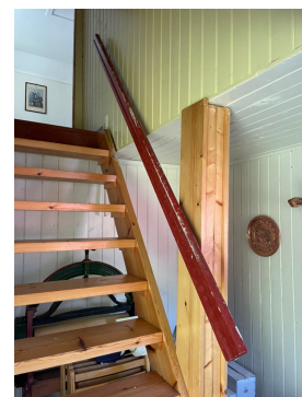
Manglende sikring i form av rekkverk.
