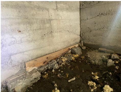
Fuktinnslag i hjørnet.
