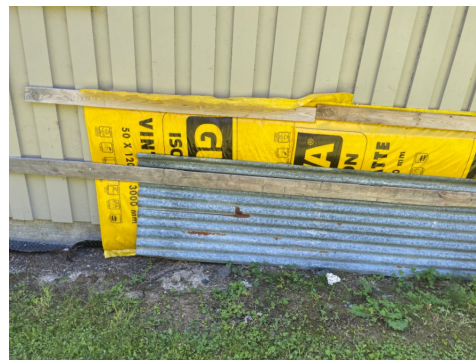
Midlertidig tiltak på yttervegg. Vannledninger utsatt for kulde
