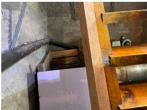
Avløpsrør i rom under terreng.
