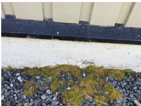
Sprekk i grunnmur på hoveddel
