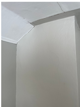
Sprekker i overflate/puss. pipe 2. etasje
