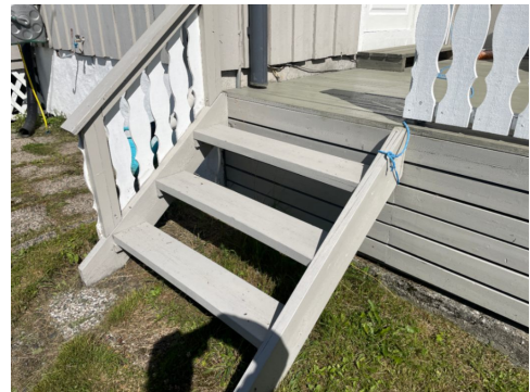
Manglende rekkverk på en
