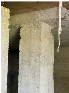
Horizontal sprekke på søylepunkt tilbygg
