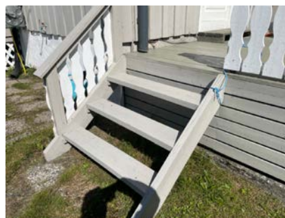
Manglende rekkverk på en
