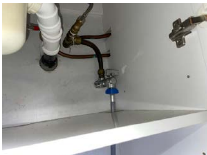
Eksempel på irr på rør
