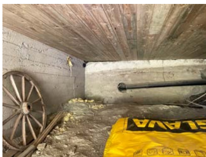
Manglende ventilering og en tett ventil.
