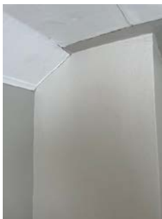
Sprekker i overflate/puss. pipe 2. etasje
