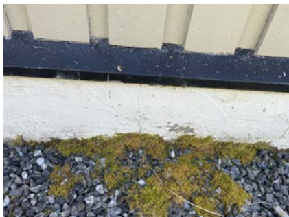
Sprekk i grunnmur på hoveddel
