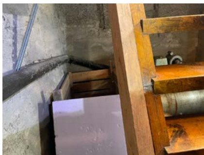
Avløpsrør i rom under terreng.
