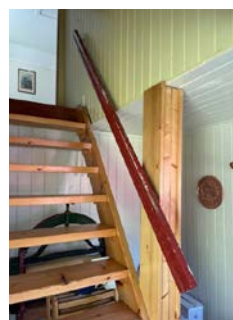
Manglende sikring i form av rekkverk.
