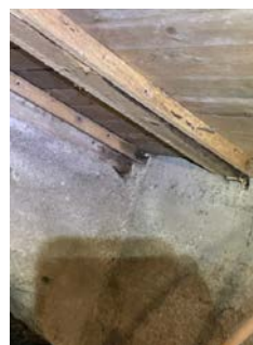
Påbegynte råteskader i bjelke ved mur.
