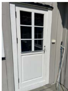
Manglende omramning ved topp karm.
