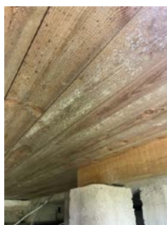
Synlig mugg/svertesopp på stubbeloft.
