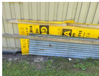
Midlertidig tiltak på yttervegg. Vannledninger utsatt for kulde
