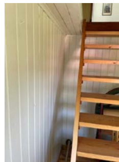
Manglende sikring i form av rekkverk og stor lysåpning mellom trinn.
