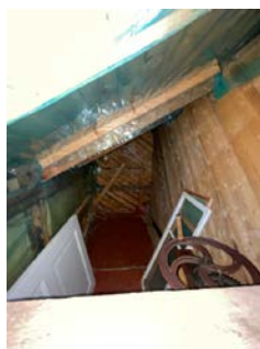
Ufaglig montering av diffusjonssperre
