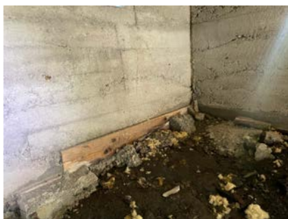
Fuktnissig i hjørnet.
