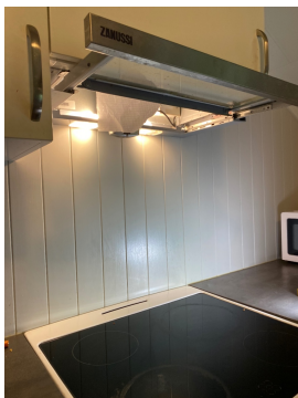
Funksjonstest av ventilator. Filter mangler.
