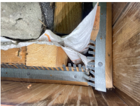
Tetting av musebånd bør utbedres.
