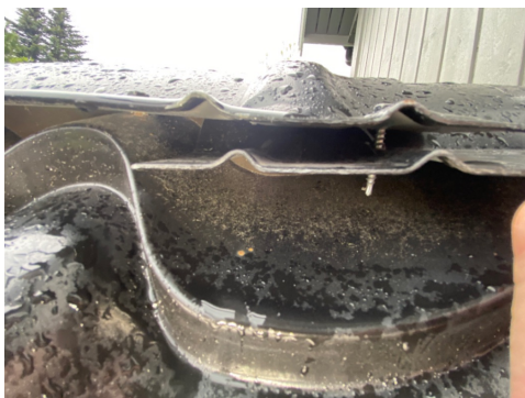
Manglende tetting under mønekam.
