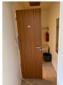
Dør mellom bad og gang, kjellerleilighet.
