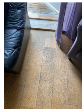
Overflater har stedvis slitasjegrad utover det en kan forvente.
