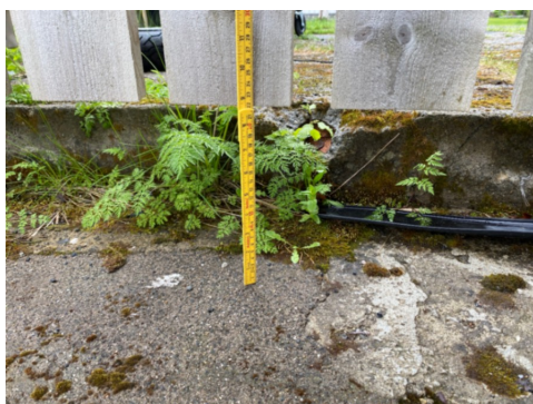
Åpninger under rekkverk.
