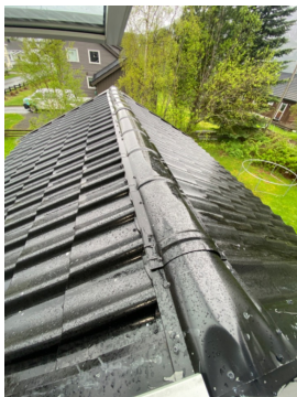
Det er påvist bulker i enkelte møneplater på takteking.
