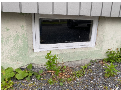
Vinduer fra byggeår mangler beslag i nedkant.
