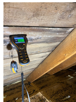
Misfarging av tretro, Det ble fuktmålt mot tretro uten forhøyde verdier.
