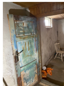
Enkelte dører må påberegnes utbyttes.
