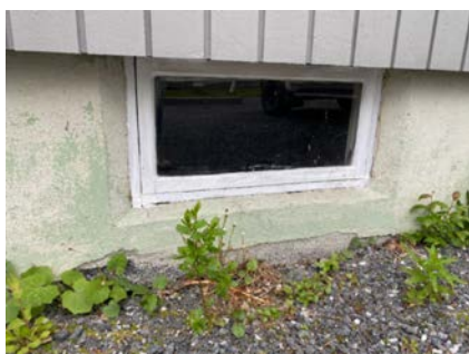
Vinduer fra byggeår mangler beslag i nedkant.
