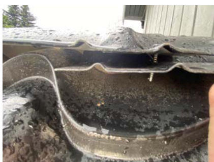
Manglende tetting under mønekam.
