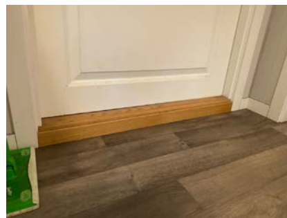
Våtrommet mangler tilluftsventilering, f.eks. spalte/ventil ved dør.
