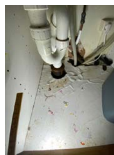
Fuktskader i skrog under utslagsvask.
