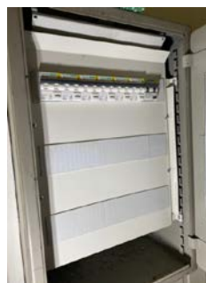
Sikringsskap med automatsikringer, plassert i gangen i kjeller.
