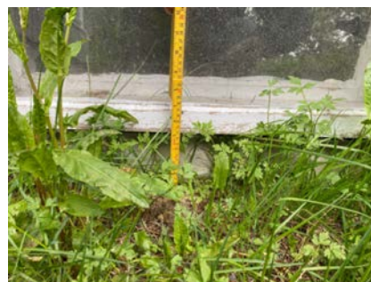
Det er ikke tilstrekkelig høyde fra terrenget til underkant vindu, vinduer skal plasseres minimum 15 cm. over terreng.
