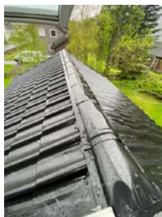
Det er påvist bulker i enkelte møneplater på taktekking.
