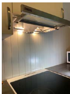
Funksjonstest av ventilator. Filter mangler.
