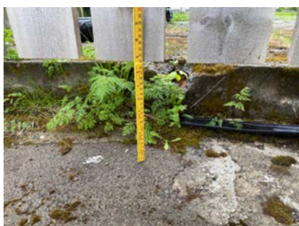
Åpninger under rekkverk.
