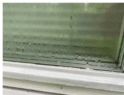
Kondens på innside av glass.
