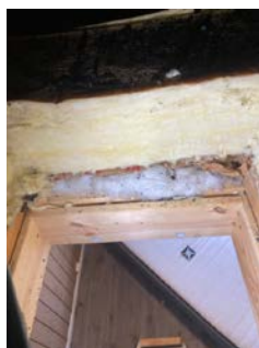
Det er ikke registrert dampsperre i taket mot kaldloft.
