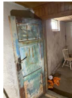
Enkelte dører må påberegnes utbyttes.
