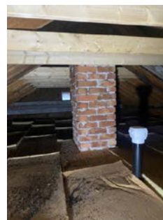
Durgoventil er montert på kaldloft
