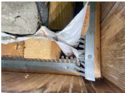
Tetting av musebånd bør utbedres.
