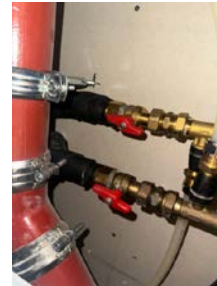
Vannrør med stoppekraner på bad.
