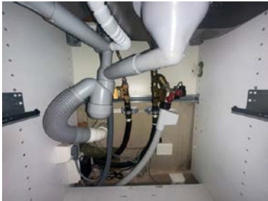
Rørpropplegg i kjøkkenbenk med Waterguard
