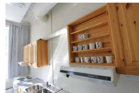
Montert ventilator med avtrekk.
