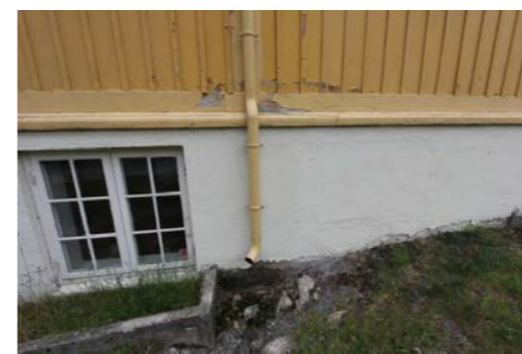
Taknedløp avsluttet over bakke.
