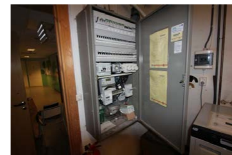
El. tavle stående i vaskerom kjeller.
