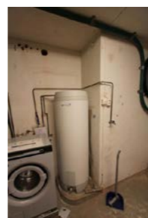
Nyer montert vvs tank vaskerom kjeller.
