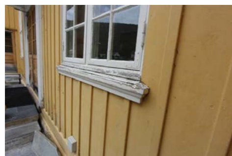
Værslitt behandling av vindusrammer.
