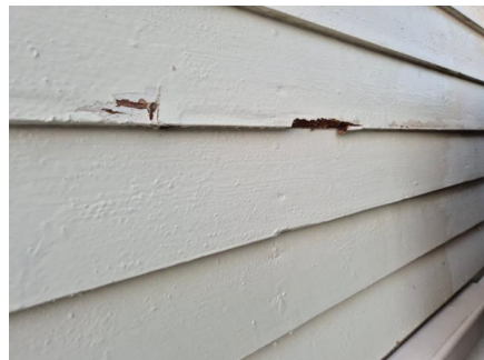
Stedvis råte i kledningsbord.
