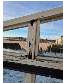
Råte i vindusrammer til terrasse.
