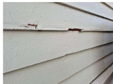
Stedvis råte i kledningsbord.
