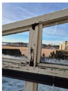
Råte i vindusrammer til terrasse.
