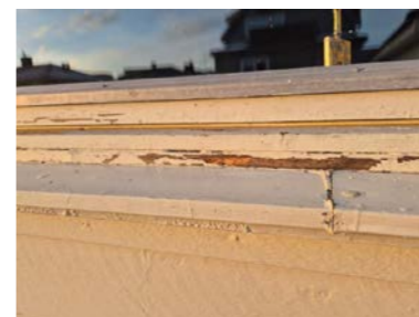
Påbegynt råte i vinduskarm.
