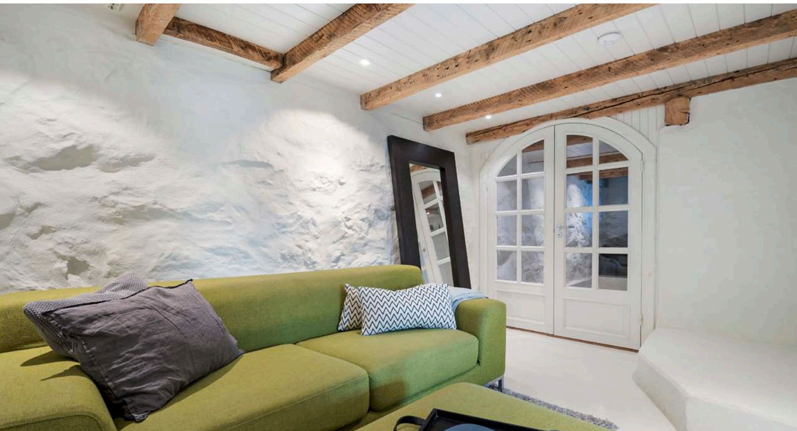
Malte murvegger. Ikke bruksendret som stue.
