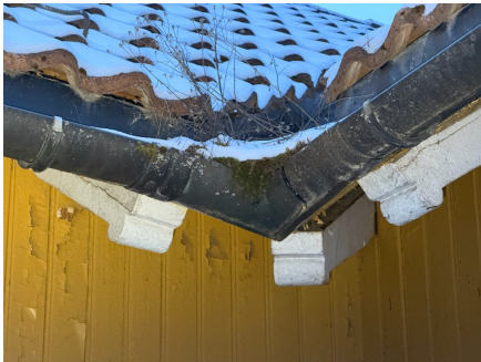
Takrenne er tettet av vegetasjon.
