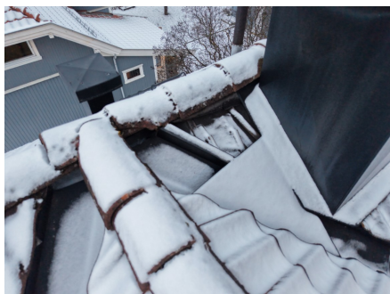
Manglende taktekking ved pipe.
