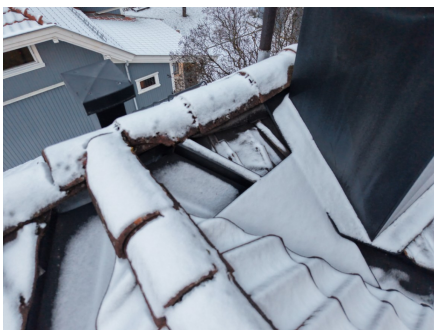
Manglende takteking ved pipe.
