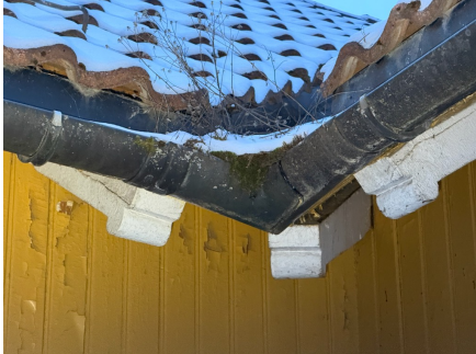
Takrenne er tettet av vegetasjon.
