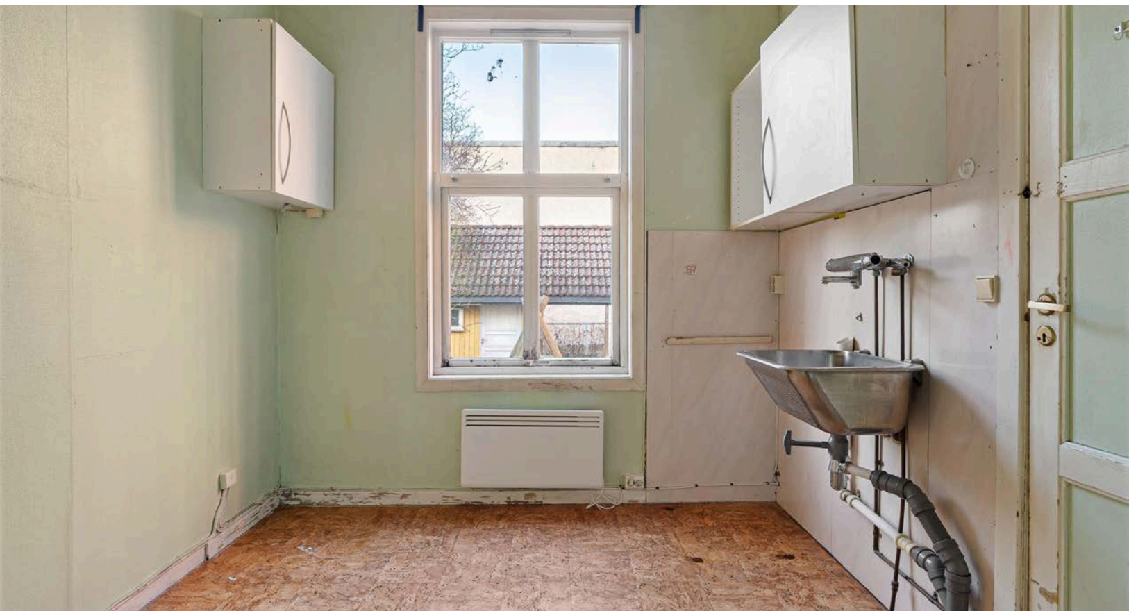
Kombinert vaskerom og toalettrom. Rommet har behov for renovering.
