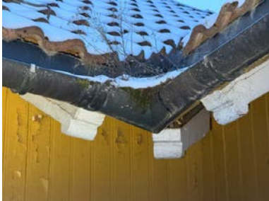
Takrenne er tettet av vegetasjon.
