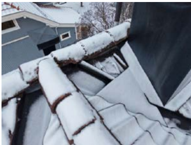
Manglende takteking ved pipe.
