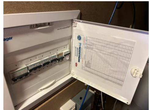
Sikringskap i teknisk rom
