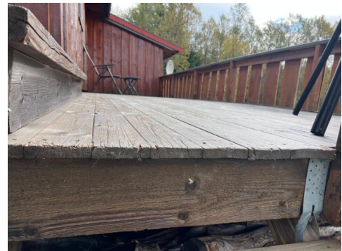
Skjevhet i terrasse
