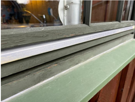
Vedlikeholdsbehov av enkelte vinduer
